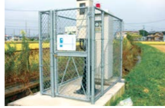
マンホールポンプ制御盤
