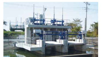
江尾江川(富士市)排水機場(ポンプゲート)
